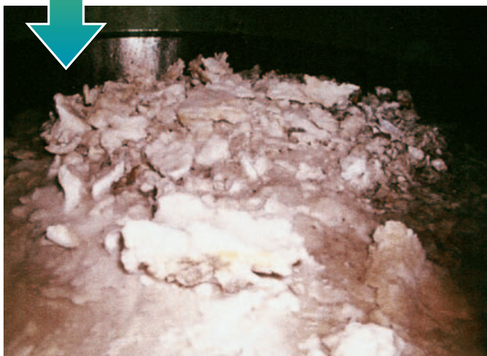
KALK-Ablagerungen in der Haustechnik
