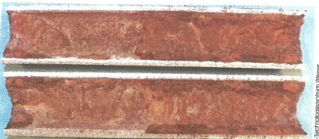
Abb. 2: Flächige Korrosion in einem verzinkten Stahlrohr, die zu Rostwasserproblemen führte.
